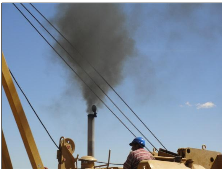
Emisión de gases de combustión
