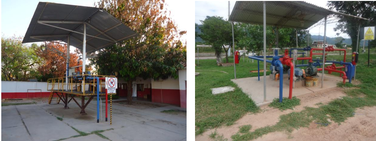
Figura 6.- Planta de Almacenaje Yacuiba
