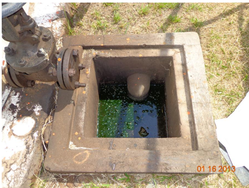
Fot. 3 CÁMARAS DE PURGA
