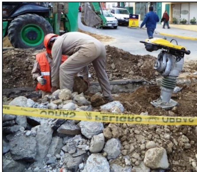
Generación de Escombros
