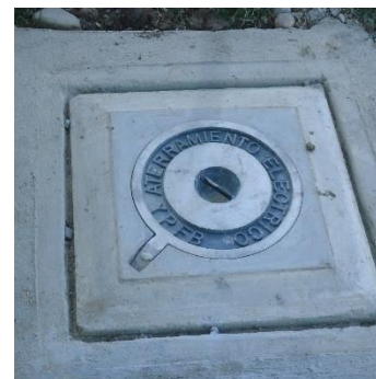
CAJA DE INSPECCIÓN
