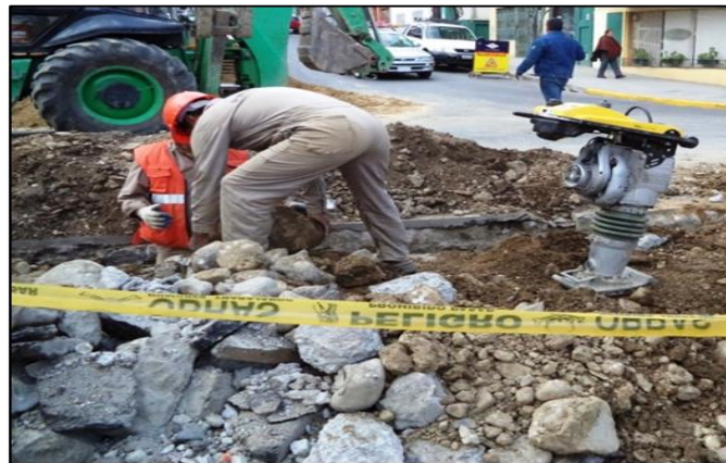
Generación de Escombros
