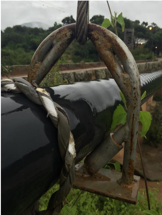
ESTRUCTURA DE SUJECION Y POSICIONADO DE TUBERIA
