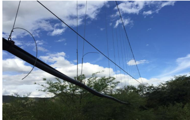
TUBERIA EXISTENTE PARA CONDUCCION DE AGUA
