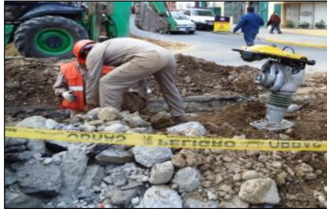
Generación de Escombros
