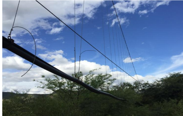
TUBERIA EXISTENTE PARA CONDUCCION DE AGUA
