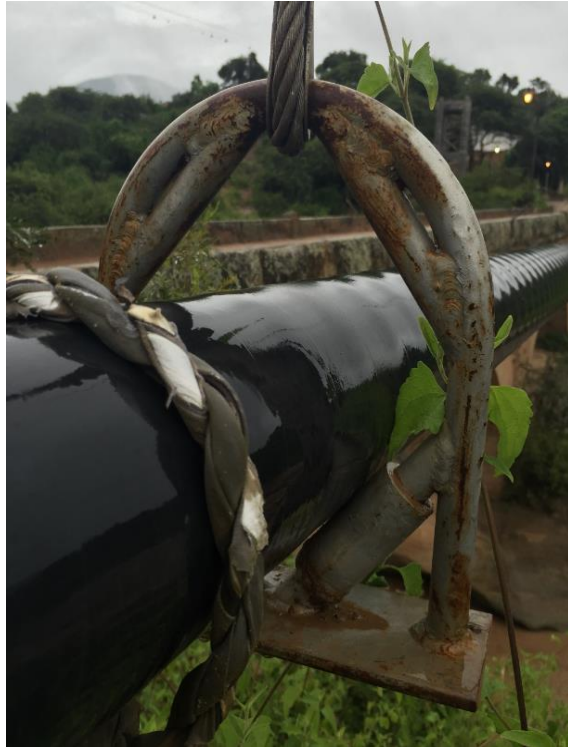
ESTRUCTURA DE SUJECION Y POSICIONADO DE TUBERIA
