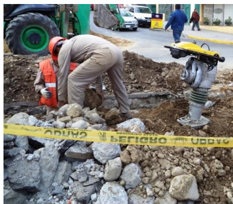
Generación de Escombros
