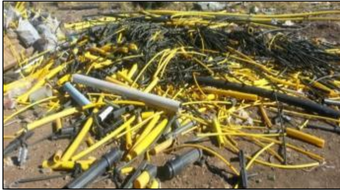
Restos de Tubería de polietileno
