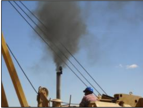
Emisión de gases de combustión
