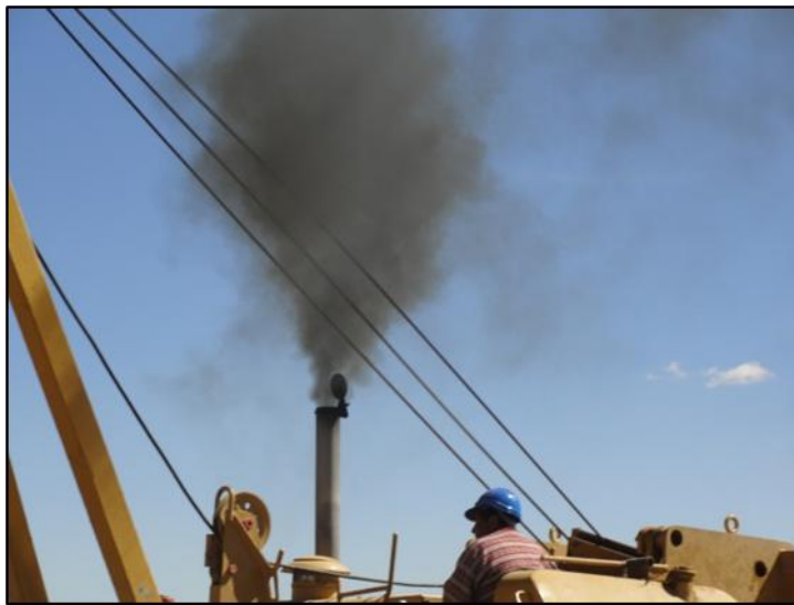
Emisión de gases de combustión
