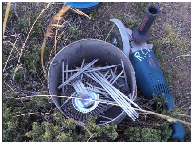
Restos de Varillas de soldar
