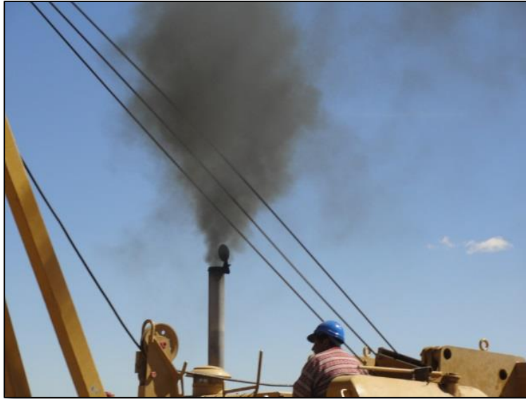
Emisión de gases de combustión
