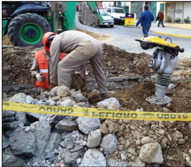
Generación de Escombros
