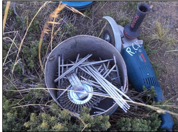
Restos de Varillas de soldar
