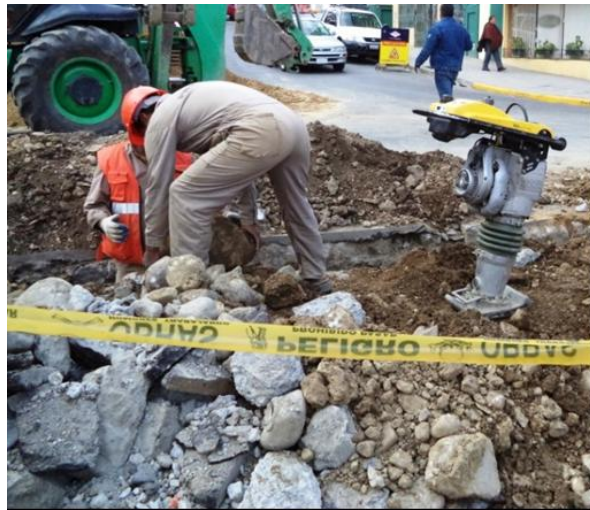
Generación de Escombros
