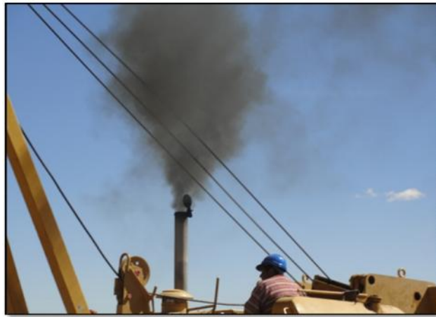
Emisión de gases de combustión
