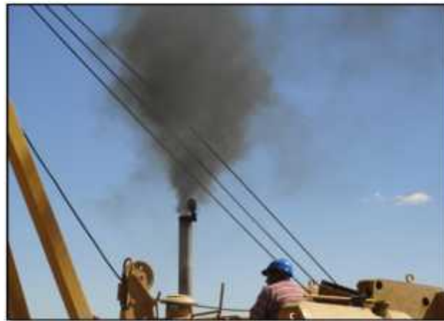
Emisión de gases de combustión
