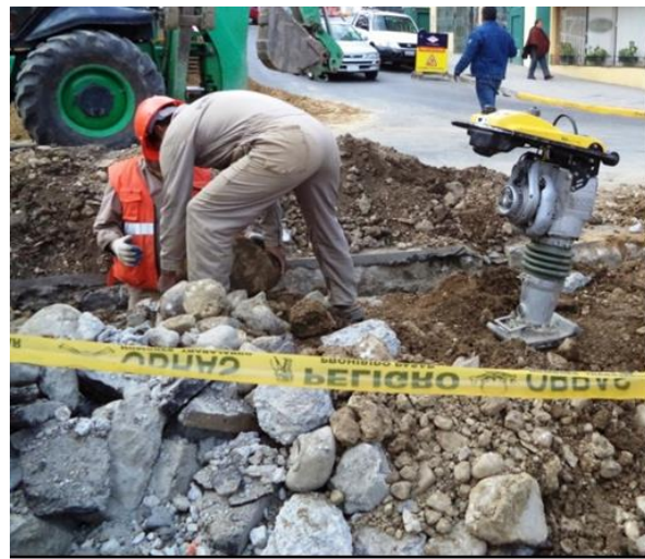
Generación de Escombros
