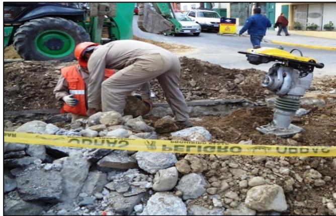
Generación de Escombros
