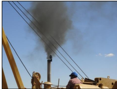
Emisión de gases de combustión
