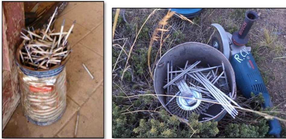
Restos de Varillas de soldar
