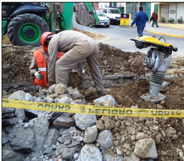
Generación de Escombros
