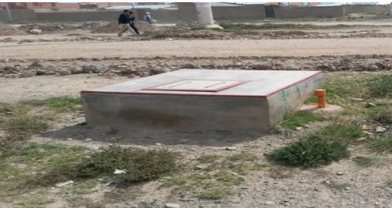
CÁMARA EXTERIOR. MOSTRANDO LAS TAPAS
