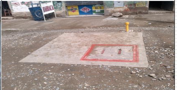
CÁMARA EXTERIOR. MOSTRANDO LAS TAPAS
