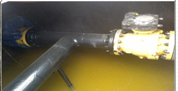
CÁMARA EXTERIOR. MOSTRANDO LAS TAPAS
