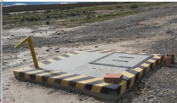
CÁMARA EXTERIOR. MOSTRANDO LAS TAPAS
