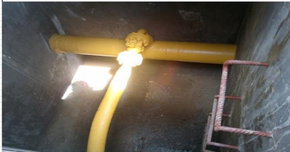
CÁMARA INTERIOR. MOSTRANDO LAS VÁLVULAS
