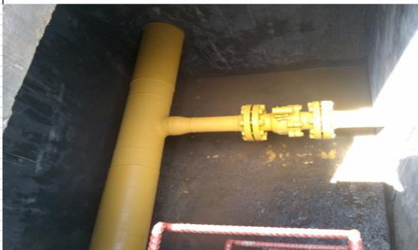
CÁMARA INTERIOR. MOSTRANDO LAS VÁLVULAS
