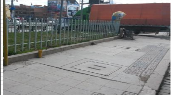
CÁMARA EXTERIOR. MOSTRANDO LAS TAPAS
