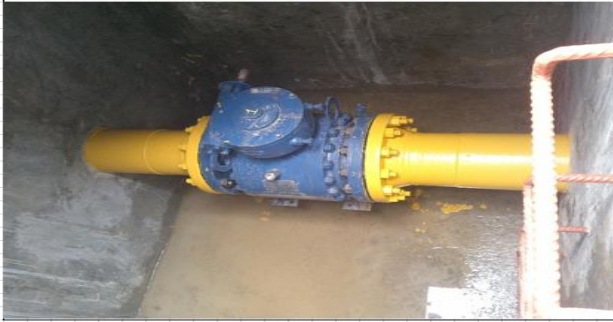
CÁMARA INTERIOR. MOSTRANDO LAS VÁLVULAS
