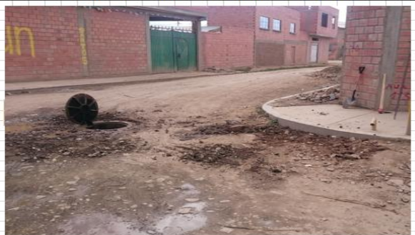
CÁMARA EXTERIOR. MOSTRANDO LAS TAPAS
