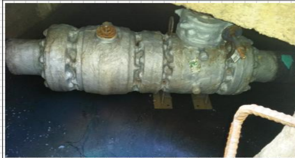
CÁMARA INTERIOR. MOSTRANDO LAS VÁLVULAS
