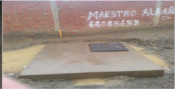
CÁMARA EXTERIOR. MOSTRANDO LAS TAPAS
