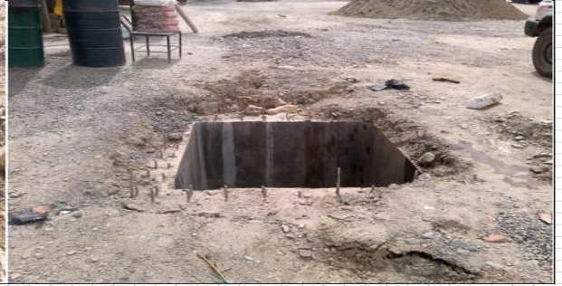
CÁMARA EXTERIOR. MOSTRANDO LAS TAPAS
