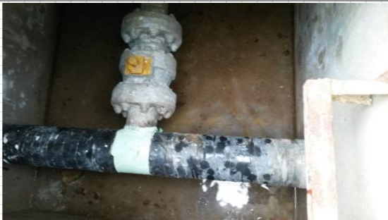
CÁMARA INTERIOR. MOSTRANDO LAS VÁLVULAS
