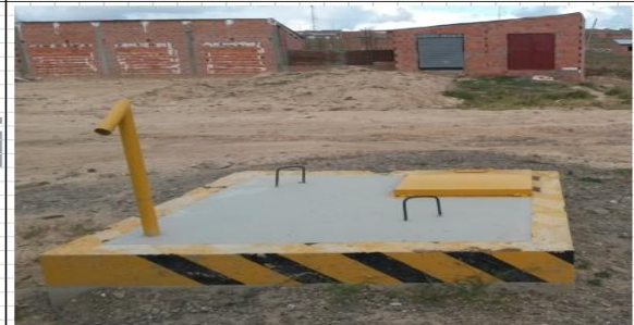
CÁMARA EXTERIOR. MOSTRANDO LAS TAPAS
