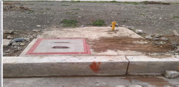
CÁMARA EXTERIOR. MOSTRANDO LAS TAPAS
