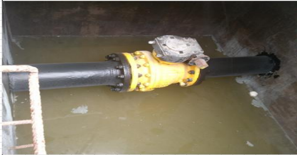
CÁMARA INTERIOR. MOSTRANDO LAS VÁLVULAS
