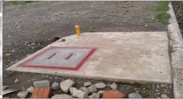
CÁMARA EXTERIOR. MOSTRANDO LAS TAPAS
