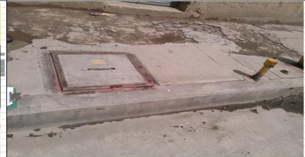
CÁMARA EXTERIOR. MOSTRANDO LAS TAPAS
