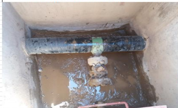
CÁMARA INTERIOR. MOSTRANDO LAS VÁLVULAS
