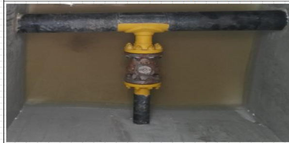
CÁMARA INTERIOR. MOSTRANDO LAS VÁLVULAS
