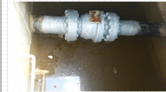
CÁMARA INTERIOR. MOSTRANDO LAS VÁLVULAS
