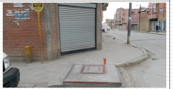
CÁMARA EXTERIOR, MOSTRANDO LAS TAPAS
