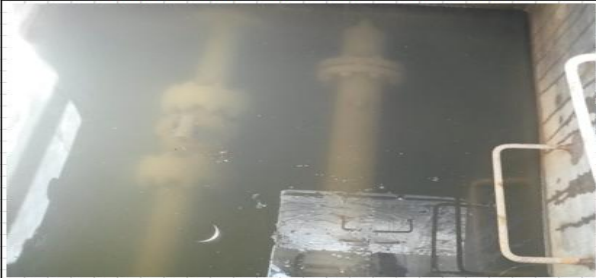
CÁMARA INTERIOR. MOSTRANDO LAS VÁLVULAS
