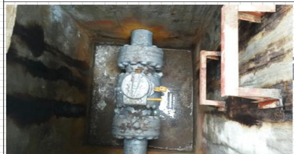
CÁMARA INTERIOR, MOSTRANDO LAS VÁLVULAS
