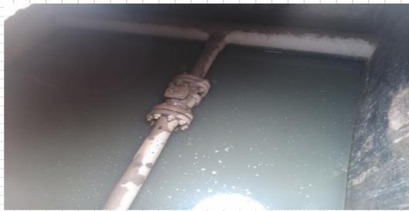
CÁMARA INTERIOR. MOSTRANDO LAS VÁLVULAS
