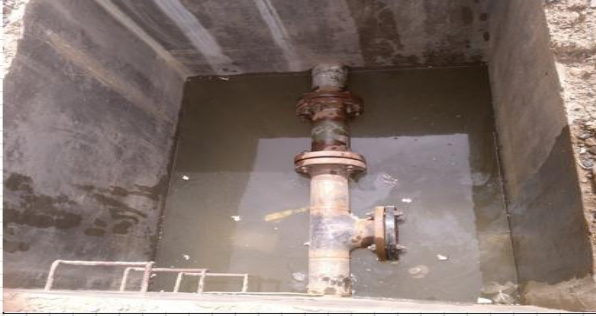
CÁMARA INTERIOR. MOSTRANDO LAS VÁLVULAS
