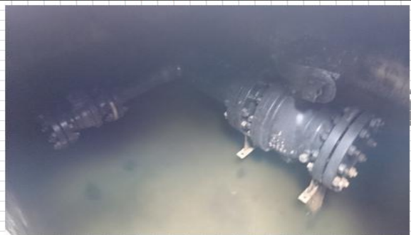
CÁMARA INTERIOR. MOSTRANDO LAS VÁLVULAS
