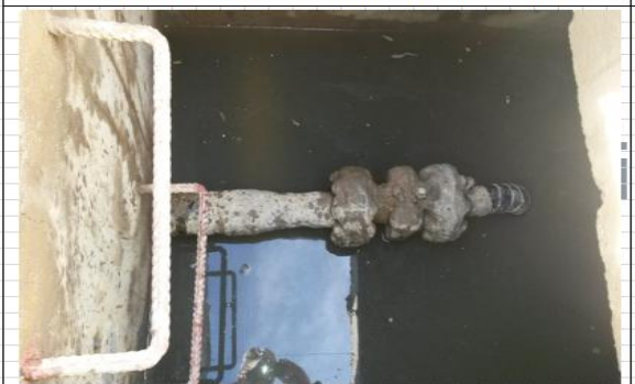
CÁMARA INTERIOR, MOSTRANDO LAS VÁLVULAS
