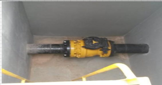
CÁMARA INTERIOR. MOSTRANDO LAS VÁLVULAS
