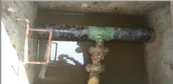
CÁMARA INTERIOR. MOSTRANDO LAS VÁLVULAS
