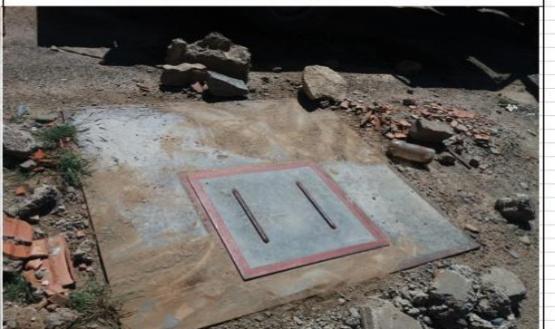
CÁMARA EXTERIOR. MOSTRANDO LAS TAPAS
