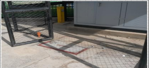
CÁMARA EXTERIOR. MOSTRANDO LAS TAPAS
