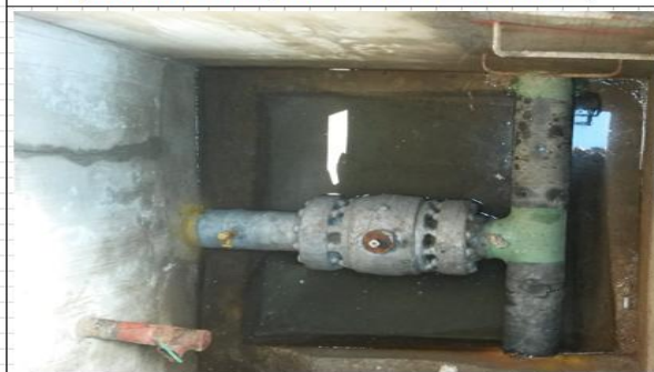
CÁMARA INTERIOR. MOSTRANDO LAS VÁLVULAS
