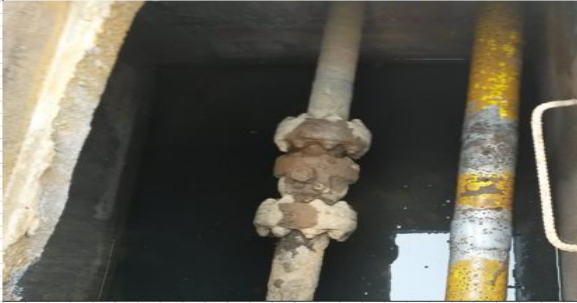
CÁMARA INTERIOR, MOSTRANDO LAS VÁLVULAS
