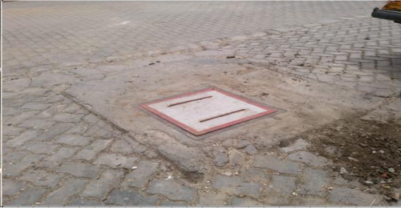
CÁMARA EXTERIOR, MOSTRANDO LAS TAPAS
