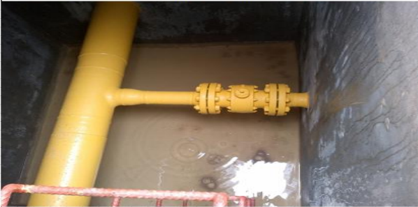
CÁMARA INTERIOR. MOSTRANDO LAS VÁLVULAS
