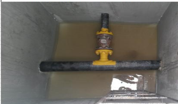
CÁMARA INTERIOR. MOSTRANDO LAS VÁLVULAS
