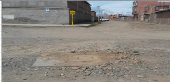
CÁMARA EXTERIOR. MOSTRANDO LAS TAPAS
