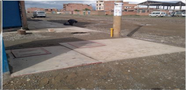
CÁMARA EXTERIOR. MOSTRANDO LAS TAPAS
