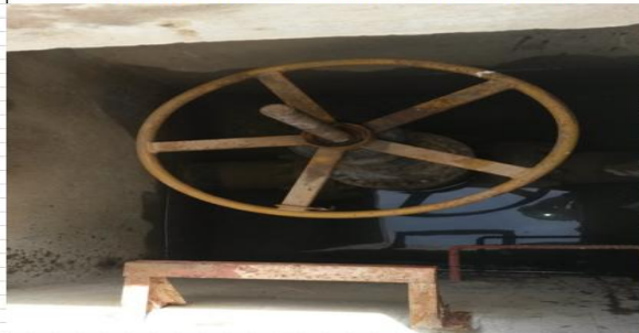
CÁMARA INTERIOR. MOSTRANDO LAS VÁLVULAS
