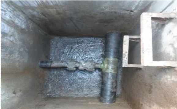
CÁMARA INTERIOR. MOSTRANDO LAS VÁLVULAS
