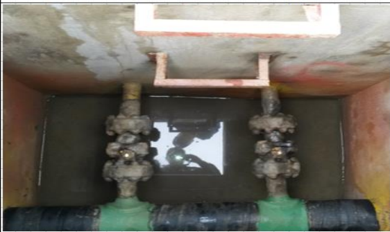
CÁMARA INTERIOR. MOSTRANDO LAS VÁLVULAS
