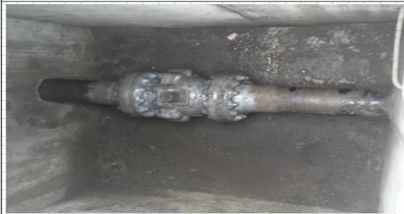
CÁMARA INTERIOR. MOSTRANDO LAS VÁLVULAS
