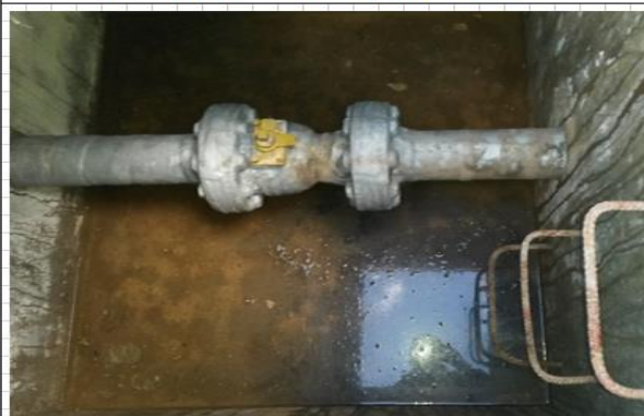
CÁMARA INTERIOR, MOSTRANDO LAS VÁLVULAS
