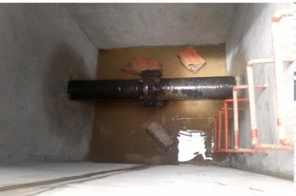
CÁMARA INTERIOR. MOSTRANDO LAS VÁLVULAS
