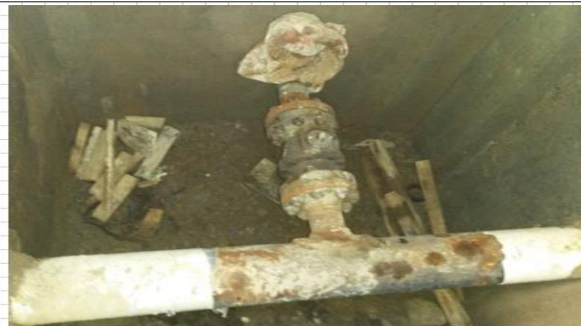
CÁMARA INTERIOR, MOSTRANDO LAS VÁLVULAS
