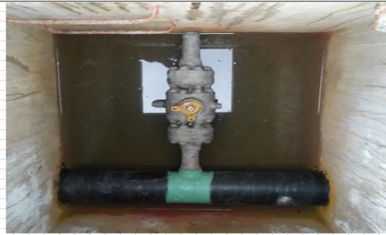
CÁMARA INTERIOR. MOSTRANDO LAS VÁLVULAS
