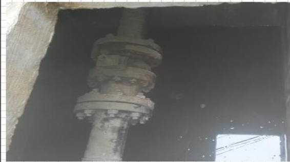
CÁMARA INTERIOR. MOSTRANDO LAS VÁLVULAS
