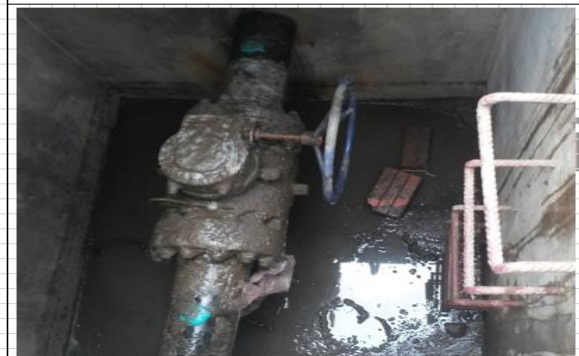
CÁMARA INTERIOR. MOSTRANDO LAS VÁLVULAS
