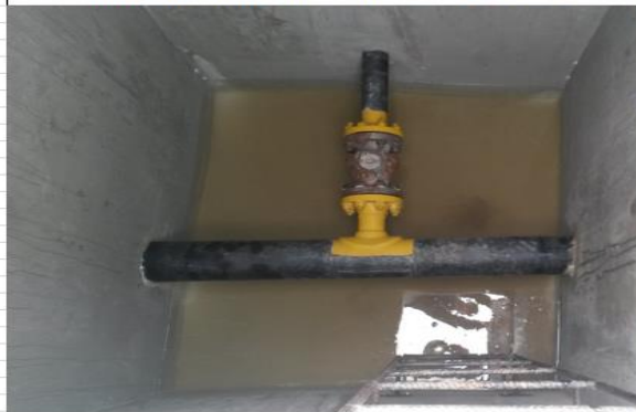
CÁMARA INTERIOR. MOSTRANDO LAS VÁLVULAS
