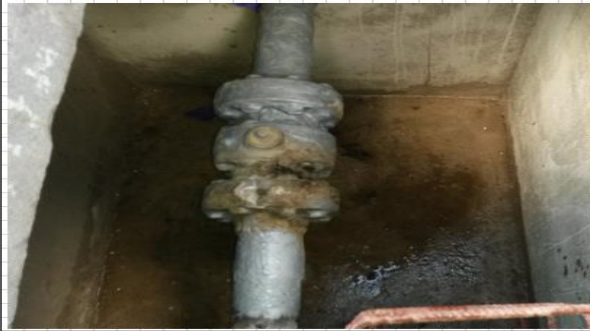
CÁMARA INTERIOR, MOSTRANDO LAS VÁLVULAS
