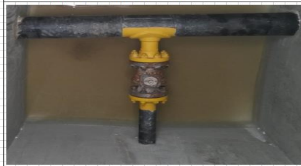
CÁMARA INTERIOR. MOSTRANDO LAS VÁLVULAS
