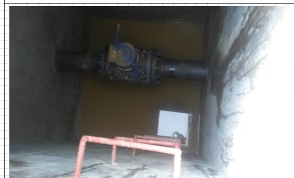
CÁMARA INTERIOR. MOSTRANDO LAS VÁLVULAS
