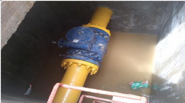
CÁMARA INTERIOR. MOSTRANDO LAS VÁLVULAS
