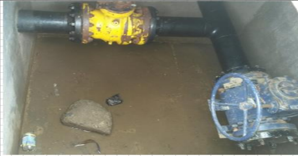
CÁMARA INTERIOR, MOSTRANDO LAS VÁLVULAS
