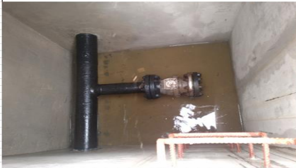
CÁMARA INTERIOR. MOSTRANDO LAS VÁLVULAS
