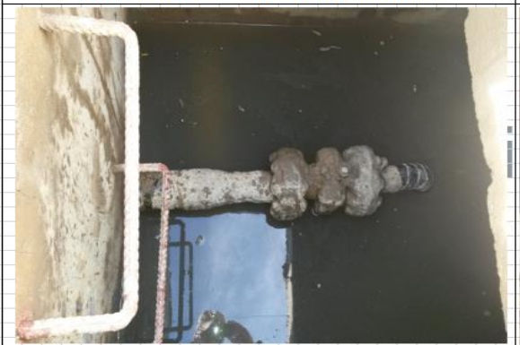
CÁMARA INTERIOR. MOSTRANDO LAS VÁLVULAS
