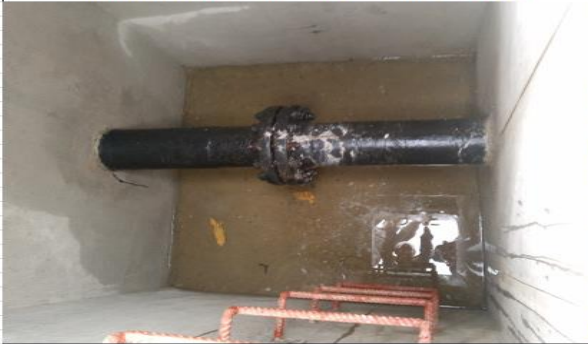
CÁMARA INTERIOR. MOSTRANDO LAS VÁLVULAS
