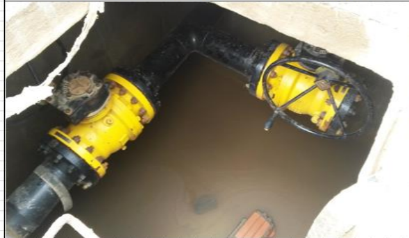
CÁMARA INTERIOR, MOSTRANDO LAS VÁLVULAS
