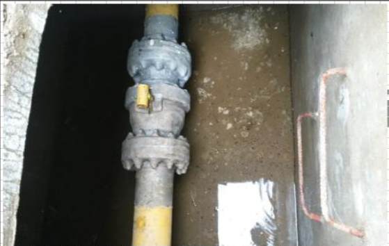
CÁMARA INTERIOR. MOSTRANDO LA O LAS VÁLVULAS
