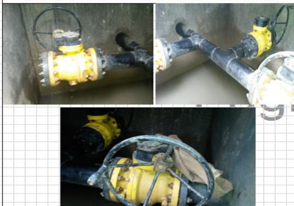
CÁMARA INTERIOR, MOSTRANDO LA O LAS VÁLVULAS
