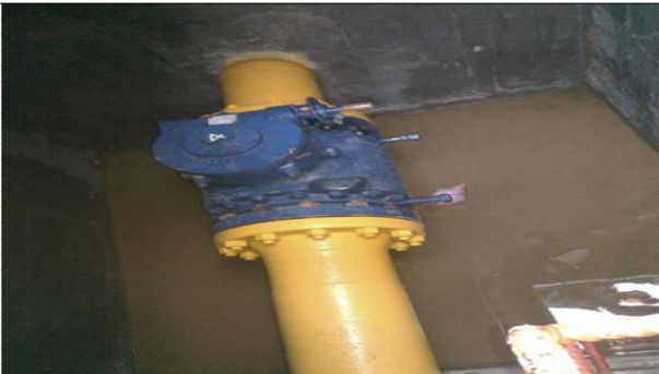
CÁMARA INTERIOR. MOSTRANDO LAS VÁLVULAS
