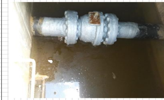
CÁMARA INTERIOR. MOSTRANDO LAS VÁLVULAS
