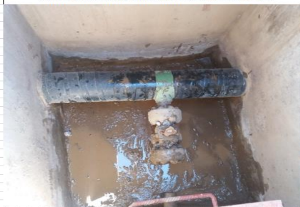
CÁMARA INTERIOR. MOSTRANDO LAS VÁLVULAS
