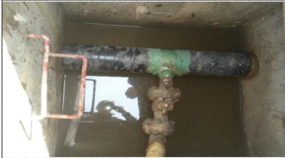
CÁMARA INTERIOR. MOSTRANDO LAS VÁLVULAS
