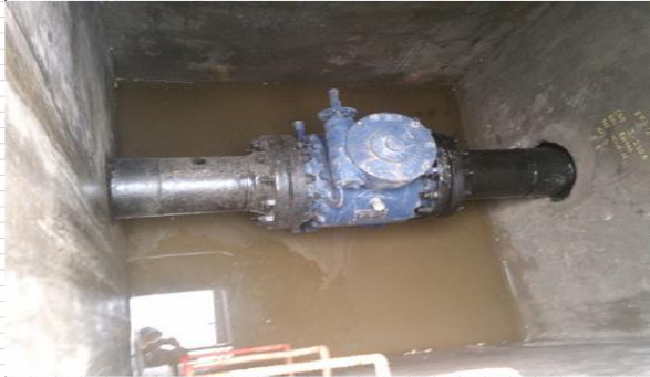
CÁMARA INTERIOR. MOSTRANDO LAS VÁLVULAS
