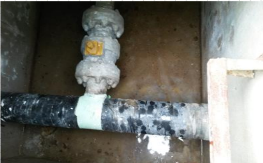
CÁMARA INTERIOR. MOSTRANDO LAS VÁLVULAS
