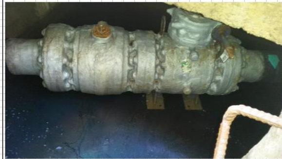
CÁMARA INTERIOR. MOSTRANDO LAS VÁLVULAS
