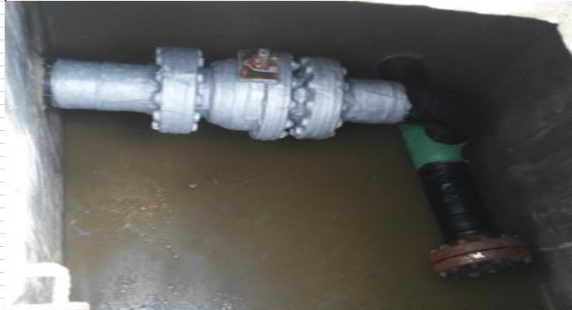
CÁMARA INTERIOR. MOSTRANDO LAS VÁLVULAS
