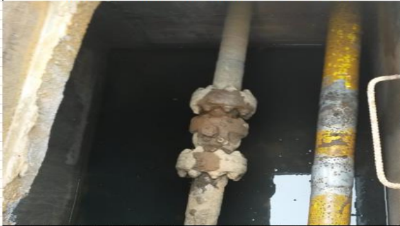
CÁMARA INTERIOR. MOSTRANDO LAS VÁLVULAS
