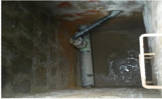
CÁMARA INTERIOR. MOSTRANDO LA O LAS VÁLVULAS
