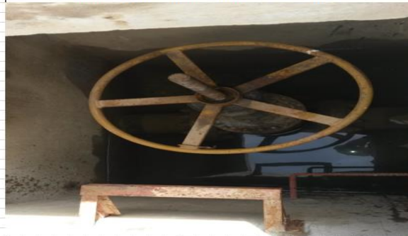
CÁMARA INTERIOR. MOSTRANDO LAS VÁLVULAS
