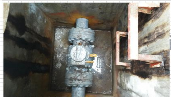
CÁMARA INTERIOR. MOSTRANDO LAS VÁLVULAS
