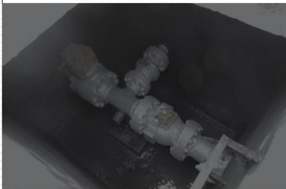
CÁMARA INTERIOR. MOSTRANDO LAS VÁLVULAS
