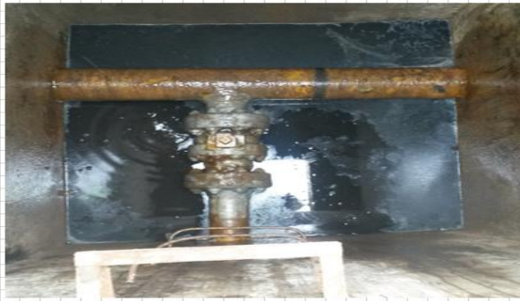
CÁMARA INTERIOR. MOSTRANDO LAS VÁLVULAS
