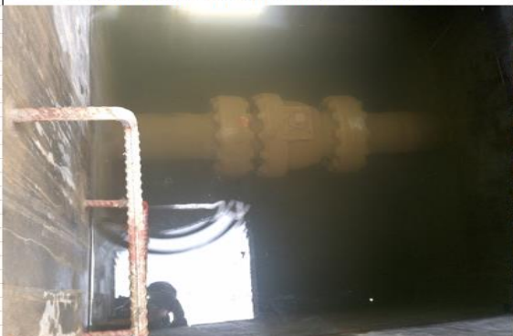
CÁMARA INTERIOR. MOSTRANDO LAS VÁLVULAS
