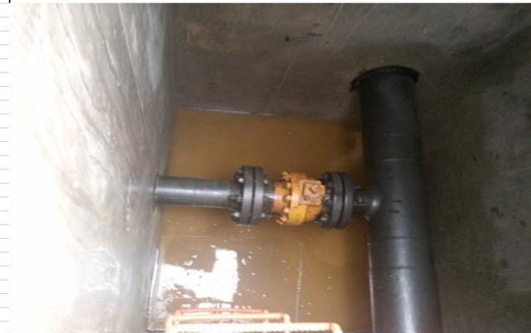
CÁMARA INTERIOR. MOSTRANDO LA O LAS VÁLVULAS
