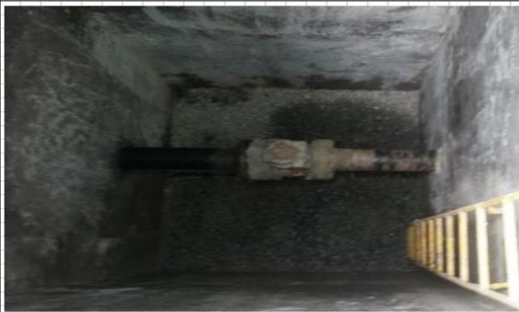
CÁMARA INTERIOR. MOSTRANDO LAS VÁLVULAS
