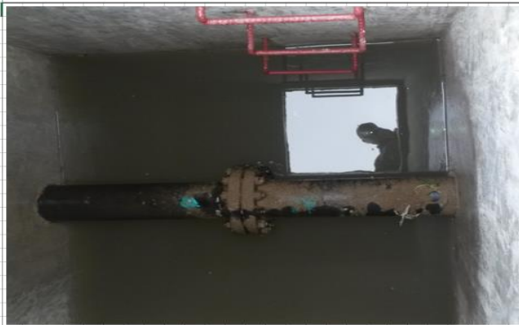
CÁMARA INTERIOR. MOSTRANDO LAS VÁLVULAS
