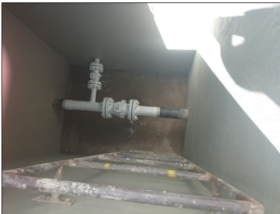
Fig. 3. Cámara de derivación a EDR Pulquina Bajo
