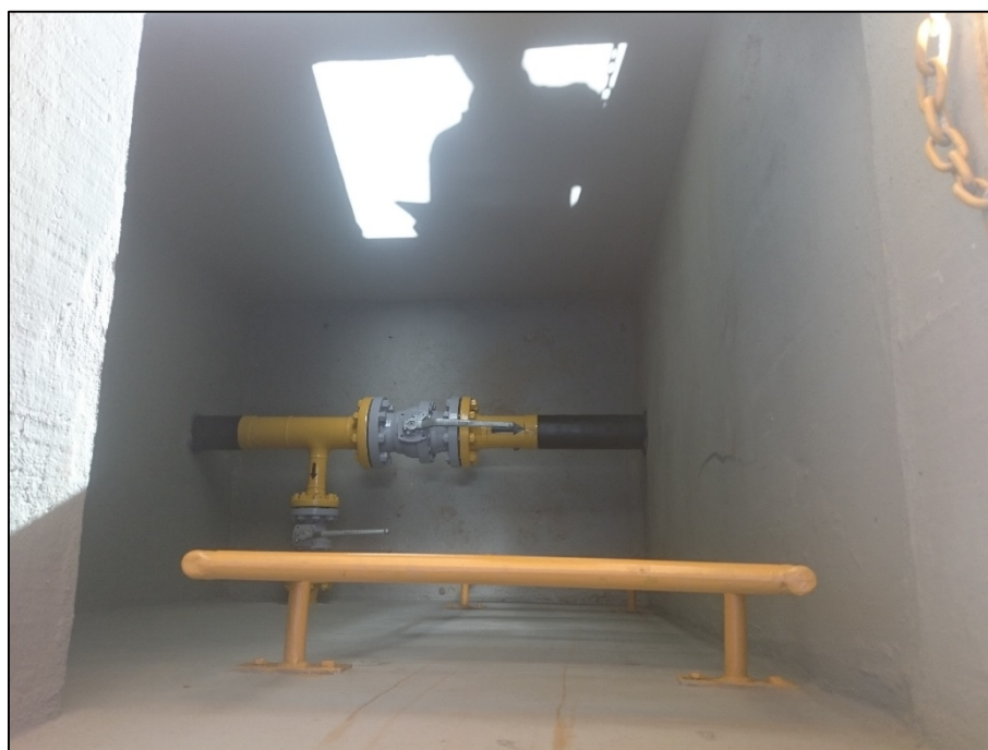
Fig. 5. Cámara de derivación a EDR San Isidro
