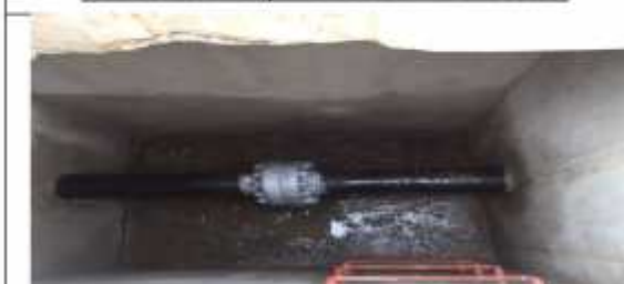
CÁMARA INTERIOR, MOSTRANDO LAS VÁLVULAS
