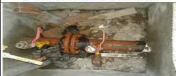
CÁMARA INTERIOR, MOSTRANDO LAS VÁLVULAS
