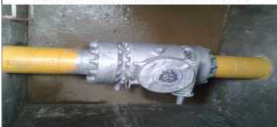
CÁMARA INTERIOR, MOSTRANDO LAS VÁLVULAS
