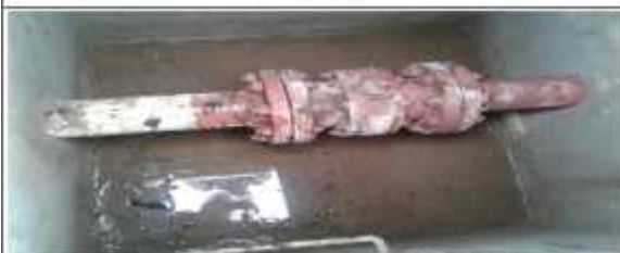
CÁMARA INTERIOR, MOSTRANDO LAS VÁLVULAS
