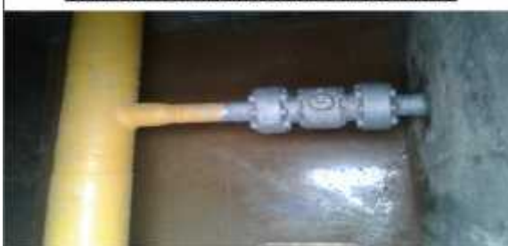
CÁMARA INTERIOR, MOSTRANDO LAS VÁLVULAS
