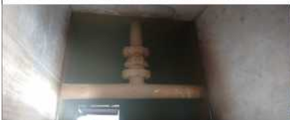
CÁMARA INTERIOR, MOSTRANDO LAS VÁLVULAS
