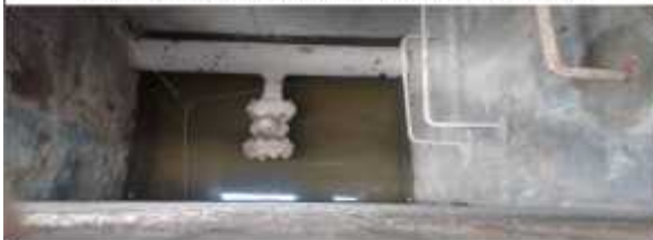
CÁMARA INTERIOR, MOSTRANDO LAS VÁLVULAS
