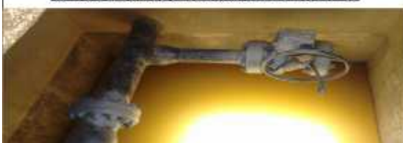
CÁMARA INTERIOR, MOSTRANDO LAS VÁLVULAS
