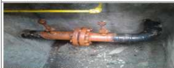
CÁMARA INTERIOR, MOSTRANDO LAS VÁLVULAS
