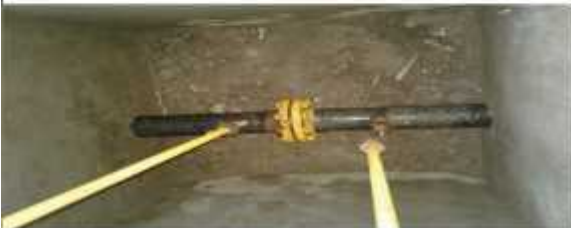
CÁMARA INTERIOR, MOSTRANDO LAS VÁLVULAS
