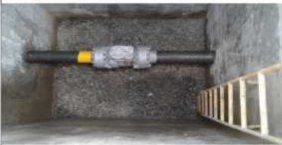
CÁMARA INTERIOR, MOSTRANDO LAS VÁLVULAS
