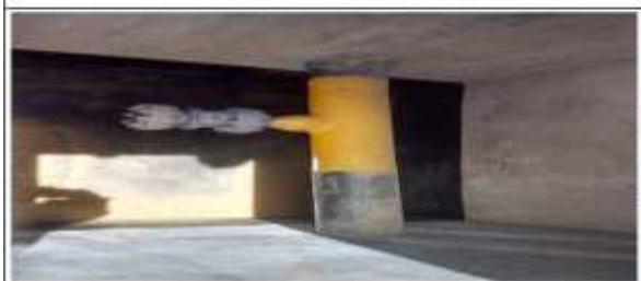
CÁMARA INTERIOR, MOSTRANDO LAS VÁLVULAS
