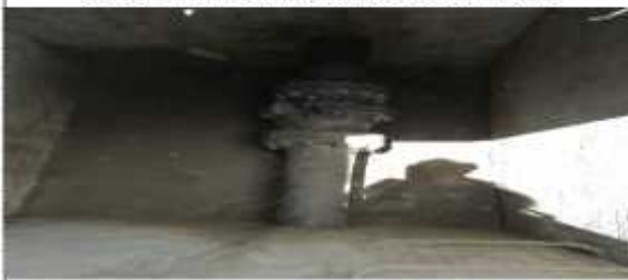
CÁMARA INTERIOR, MOSTRANDO LAS VÁLVULAS
