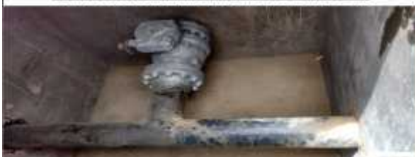
CÁMARA INTERIOR, MOSTRANDO LAS VÁLVULAS
