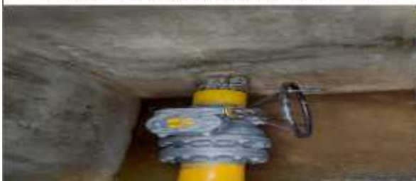
CÁMARA INTERIOR, MOSTRANDO LAS VÁLVULAS
