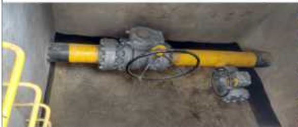
CÁMARA INTERIOR, MOSTRANDO LAS VÁLVULAS
