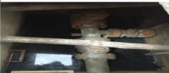
CÁMARA INTERIOR, MOSTRANDO LAS VÁLVULAS
