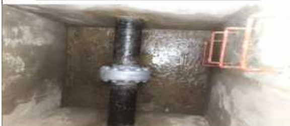
CÁMARA INTERIOR, MOSTRANDO LAS VÁLVULAS
