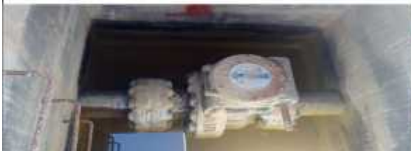
CÁMARA INTERIOR, MOSTRANDO LAS VÁLVULAS
