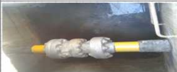
CÁMARA INTERIOR, MOSTRANDO LAS VÁLVULAS
