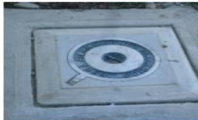
CAJA DE INSPECCIÓN
