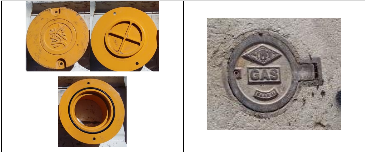
GRÁFICO 5. TIPOS DE TAPA PARA CÁMARAS EN RED SECUNDARIA INSTALADOS
