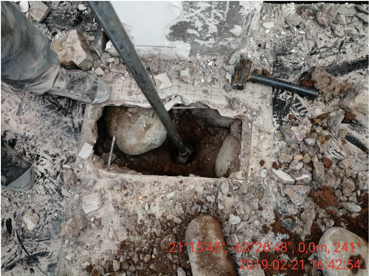
Foto 16: se observa el piso dentro del edificio y el sobrecimiento, que fue roto, y se comenzaba a realizar una perforación con una vizcachera. Se observa el enmallado de hierro del piso de hormigón y el sobrecimiento de rocas abajo del mismo.
