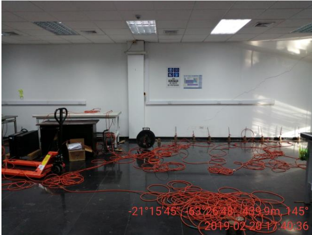
Foto 6: se observa el tendido de la L3 dentro del laboratorio.
