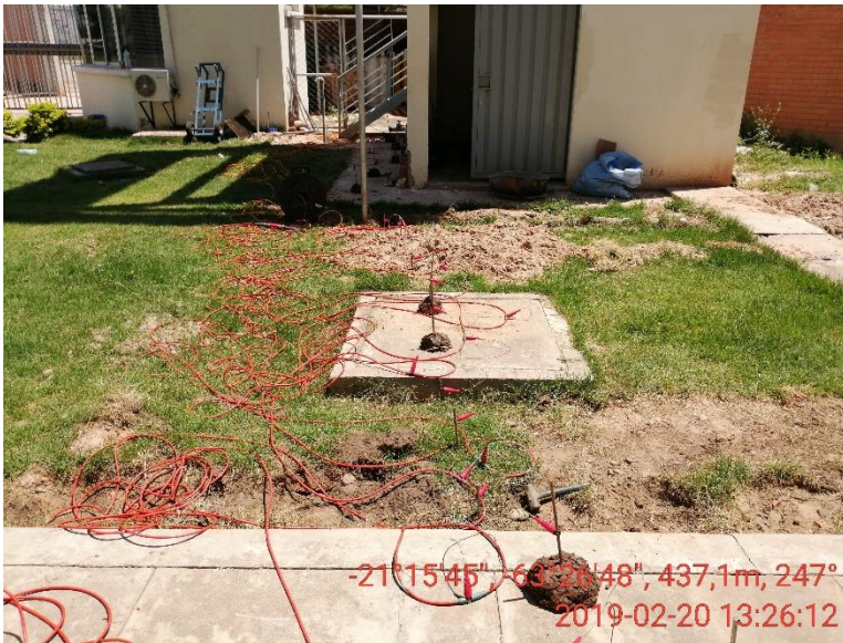
Foto 1: se observa el tendido de la L1 hacia el lado Oeste o exterior del edificio.
