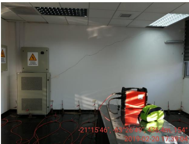
Foto 6: se observa el tendido dentro del edificio. Al fondo a la izquierda puede verse un tablero eléctrico, dentro del laboratorio.
