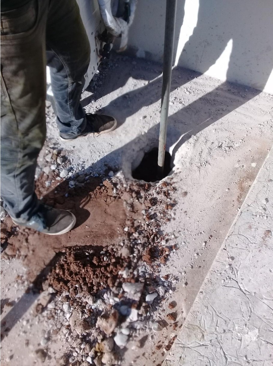
Foto 18: Se observa la rotura del pasillo de Hormigón ciclópeo. El suelo obtenido presentaba casi igual humedad que el de la foto 7.
