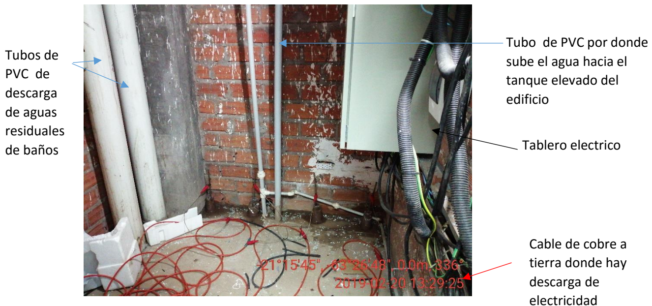
Foto 2: se observa el Shaft de Servicios con las cámaras.
