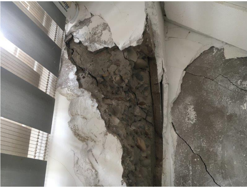
Foto 3: se observa grieta de la columna y de la pared en 45° columna 2.
