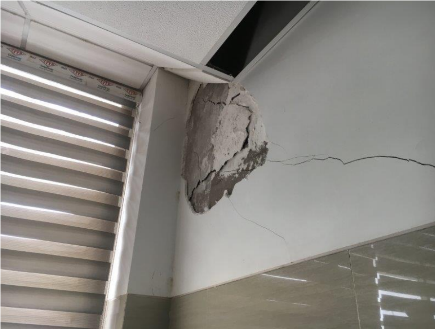
Foto 7: se observa el mismo patrón de grietas en la pared columna 1.
