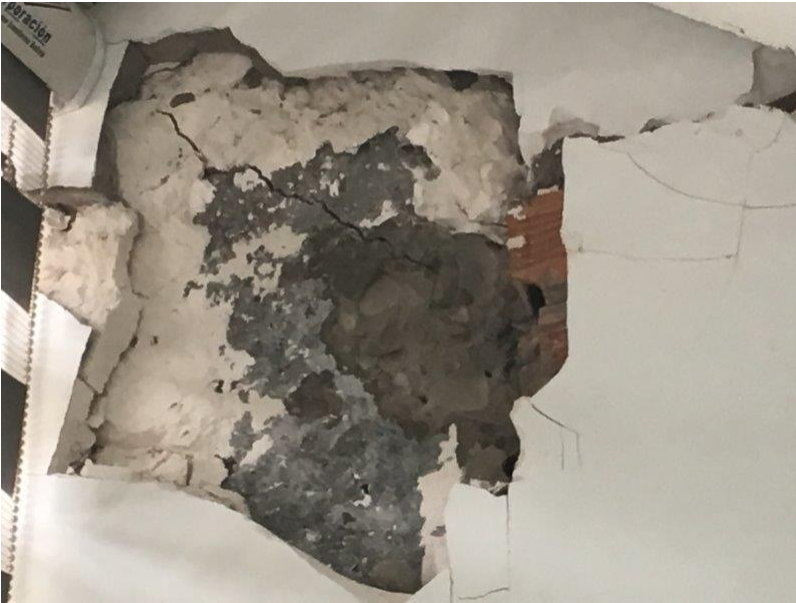
Foto 2: se observa una grieta en la columna con una dirección de 45° columna 3.
