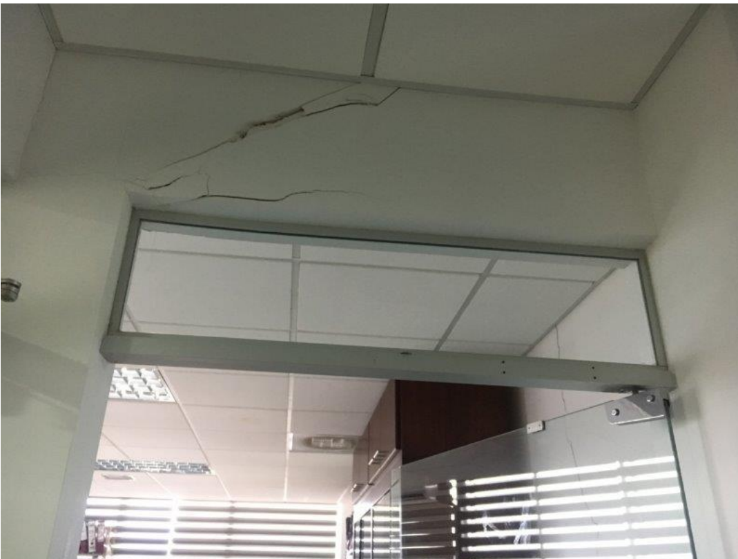
Foto 8: columna y pared interna con presencia de grietas. Esta se presenta en la segunda hilera de columnas, pero se observa en la pared, con sentido contrario a la primera hilera de columnas que están del lado oeste.
