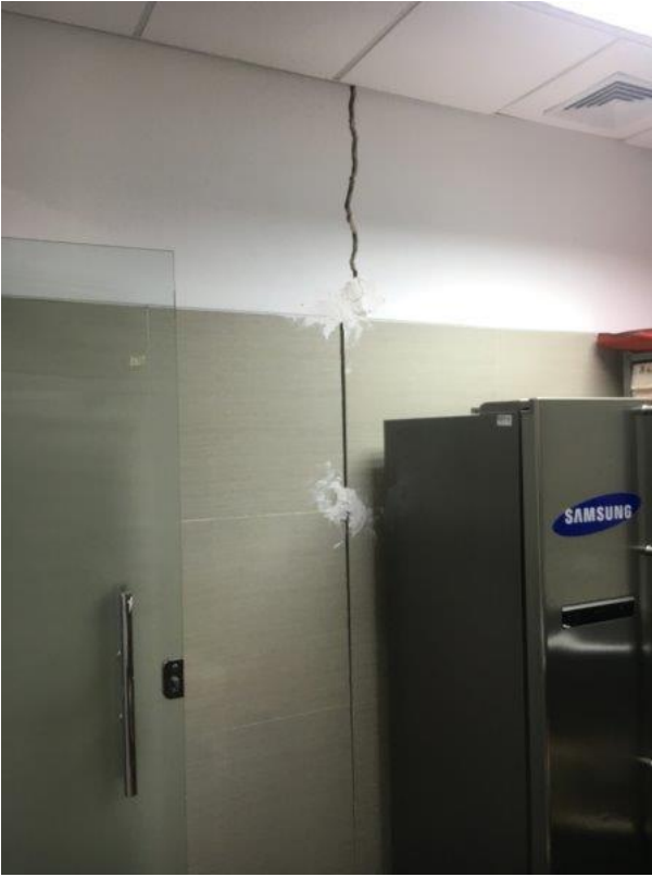
Foto 5: se observa otra grieta vertical pero en la pared con desplazamiento hasta el suelo.
