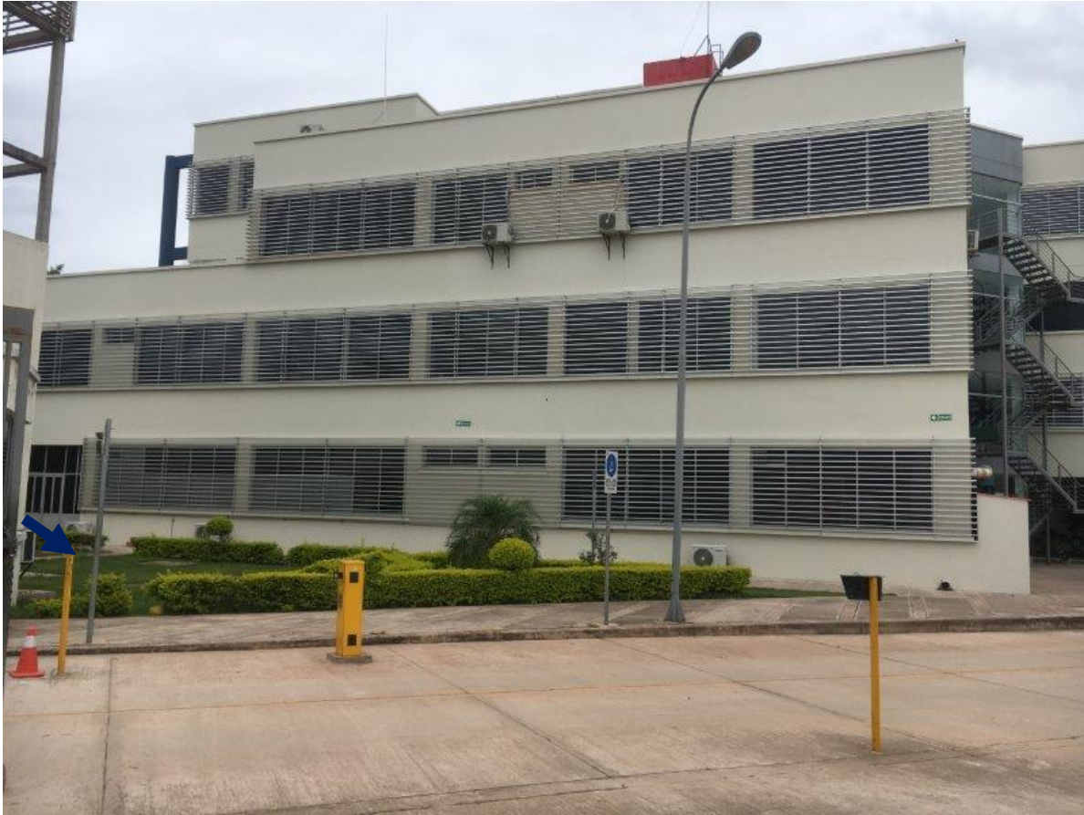
Foto 10 se observa el edificio con las dos primeras hileras de columna, y el lado derecho de donde proviene la infiltración de agua dada por la flecha azul.
