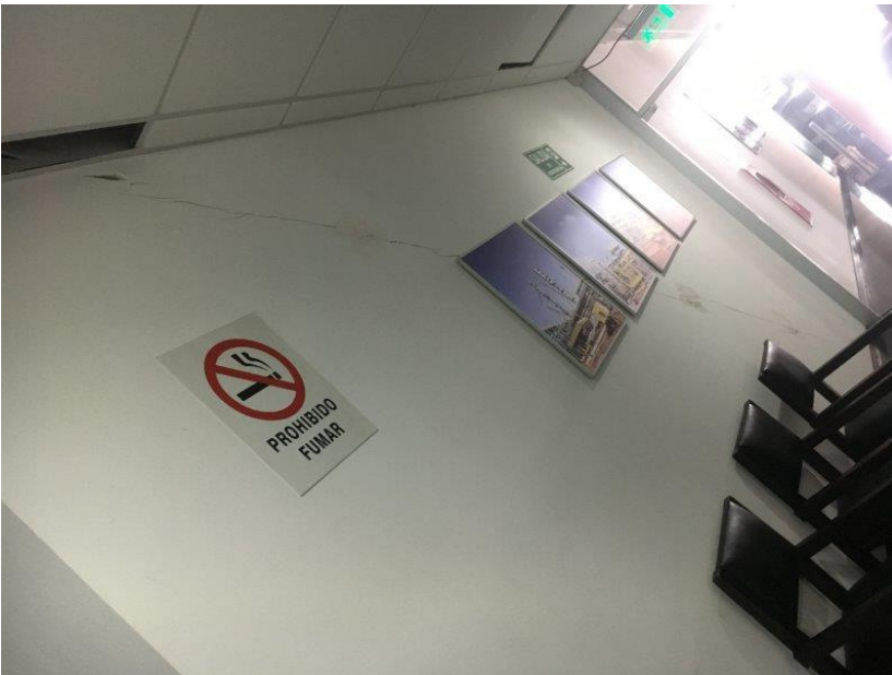
Foto 6: otra grieta en la pared .
