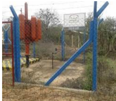
Foto-06 Válvula de Bloqueo a 3.5 km Del complejo petroquímico
